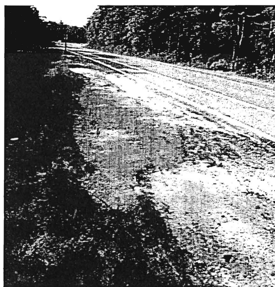
Bad use of fill
